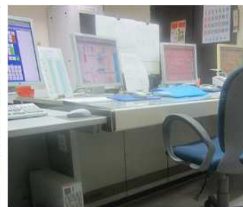
用水管理センター操作室
